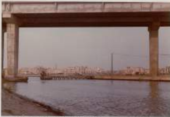
EMPLACEMENT DU COURANTOMETRE SOUS LE PONT DE LA COUREGE
